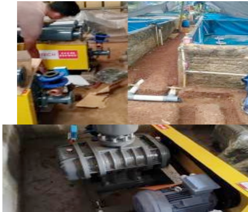
Gambar. 3 Instalasi Teknologi Mesin Supercharger dan Sistem Perpipaan Di Lokasi Mitra
