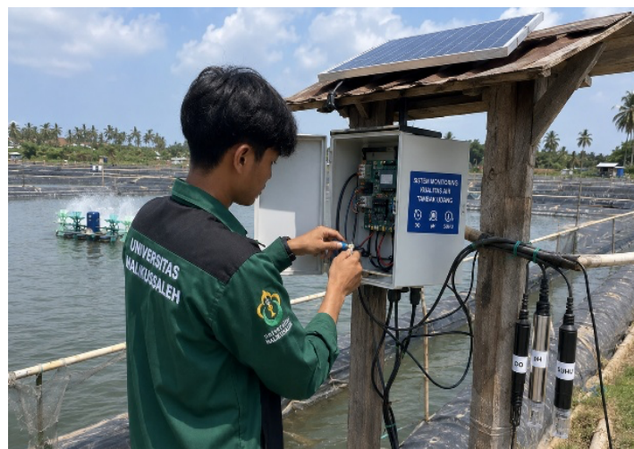
Gambar 3. Instalasi Perangkat IoT di Salah Satu Tambak Mitra Petambak di Lancang Barat Kecamatan Dewantara Aceh Utara
