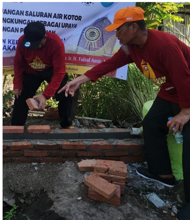
Gambar 5. Saluran air buangan rumah tangga
