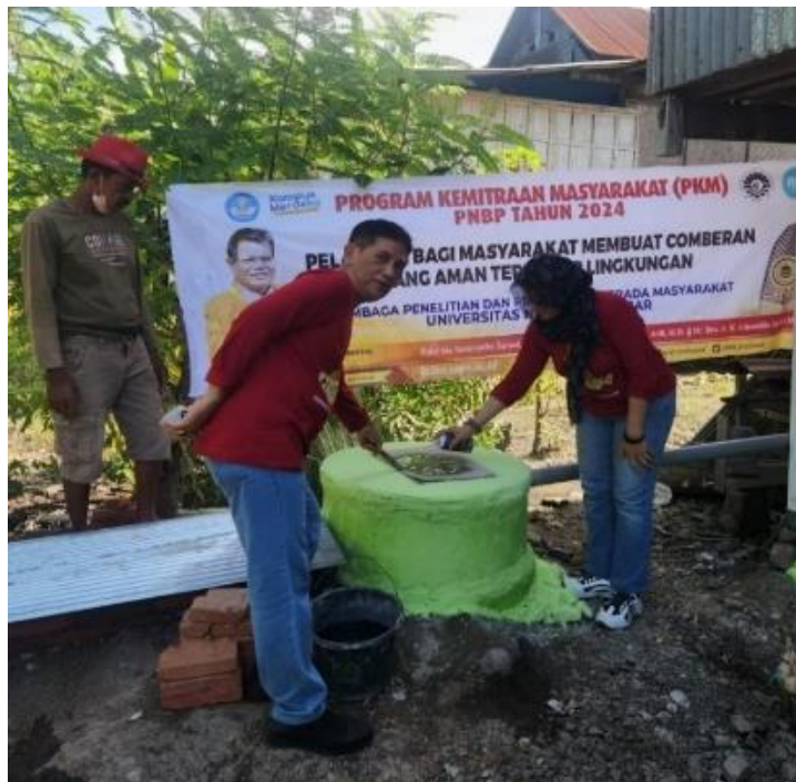
Gambar 6. Bak penampungan air buangan rumah tangga
